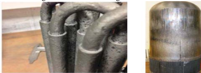
Abb. 6: Korrosion am Erhitzerkopf sowie Verschleißspuren am Expansionskolben (Fraunhofer 2013).
