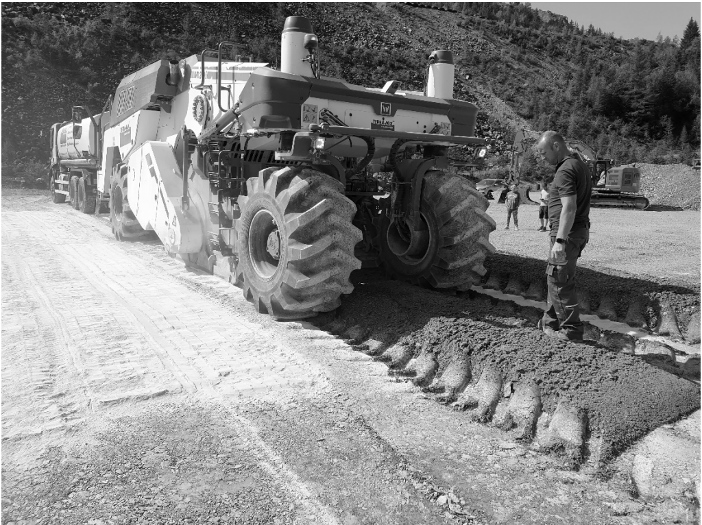
Abb. 2: Einfräsen von Bentonit sowie Zerkleinerung des Werfener Schiefers auf das geforderte Größtkorn
