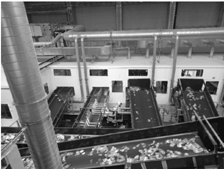
Abb. 2: Blick in die Sortieranlage
