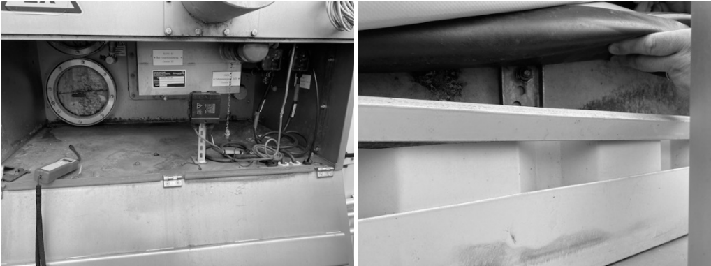
Abb. 3: Undichtigkeiten an Schaugläsern und Membrandachbefestigung. Daher Zugänglichkeit, und regelmäßige Kontrolle erforderlich, ansonsten wäre Abdeckung links in eine Zone einzuteilen
