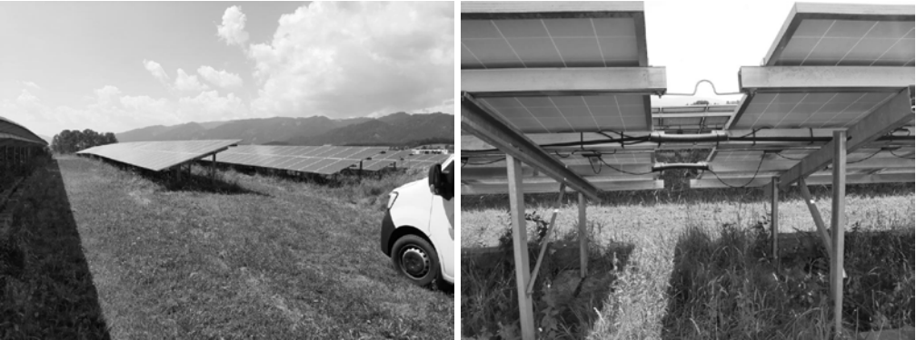
Abb. 1: PV-Anlage Deponie Pausendorf des AWV Knittelfeld (inkl. Verankerungsdetail - rechts)
