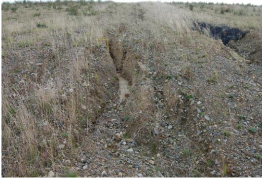
Abb. 3: Erosion am Fußbereich einer Böschung
