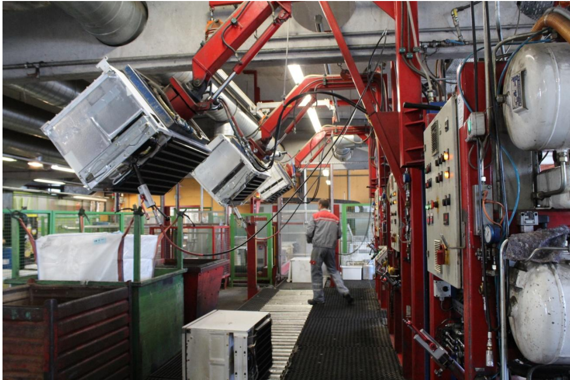
Abb. 2: Kühlgeräterecycling-Linie der AVE in Timelkam
