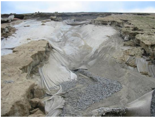
Abb. 5: Erosion, flächige Zerstörung der Abdeckung
