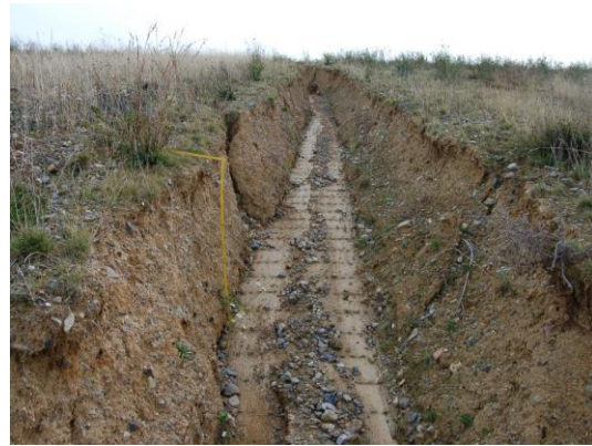
Abb. 4: Erosion bis auf die Dränmatte
