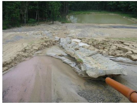
Abb. 6: Erosion mit Zerstörung von Einbauten
