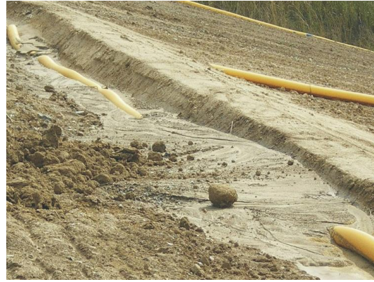
Abb. 8: Abgeschwemmte Anteile in einem Graben
